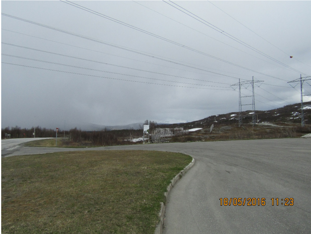
Figur 20 Statnett sine høyspentmaster på Heia. Foto: Lars Greger Bakken, Statens vegvesen
